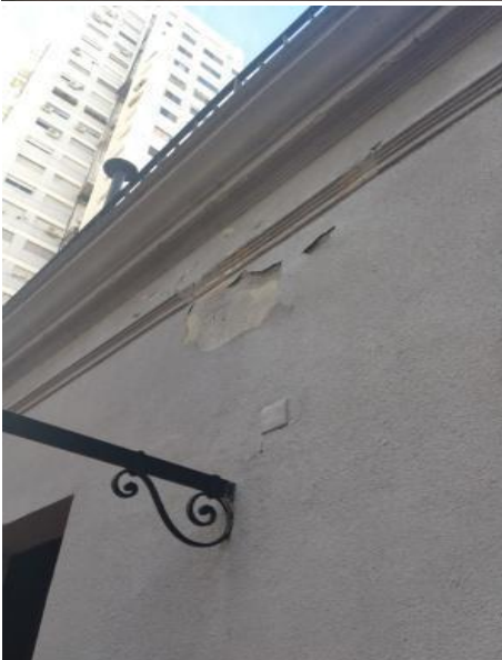
FACHADA A REPARAR
