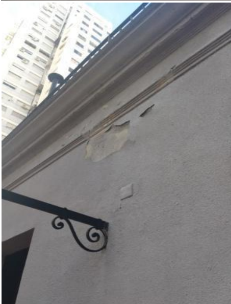
FACHADA A REPARAR
